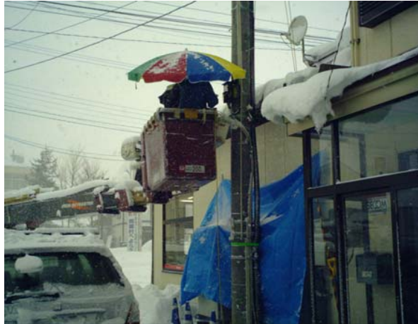
SOG リレー試験
