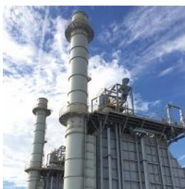
[千葉] 中袖クリーンパワー 98MW 天然ガス
