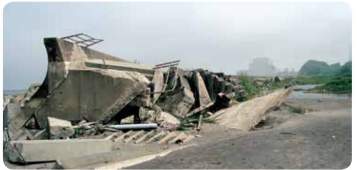
津波に破壊されたままの防潮堤
