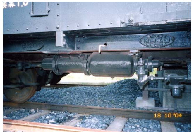
写真7 KCブレーキシステム (左からBC、補助空気溜、K三動弁)
