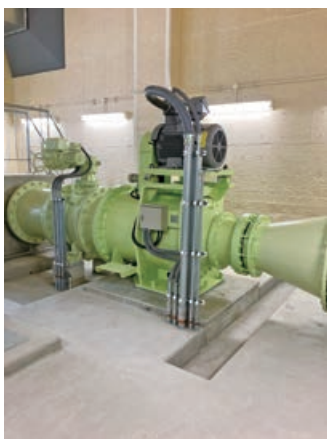
平津小水力発電所
